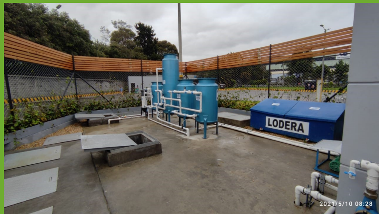
Fotografía. Sí18 (2021) PTAR 1
